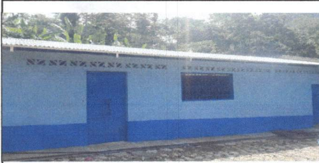
Foto1: pared restaurada del aula.
